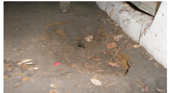
津波による換気口から水圧による穴
