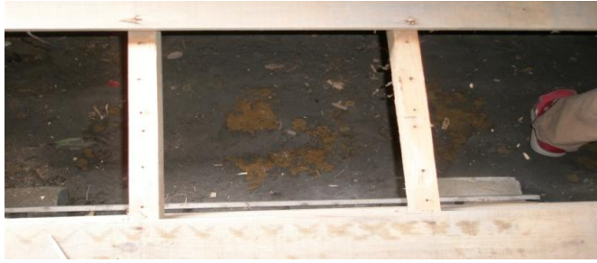
ヘドロ、沈殿物(床下)津波3週間後でも乾かない
